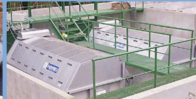
2 filtres 28-160 sur bâti en sortie de pisciculture
